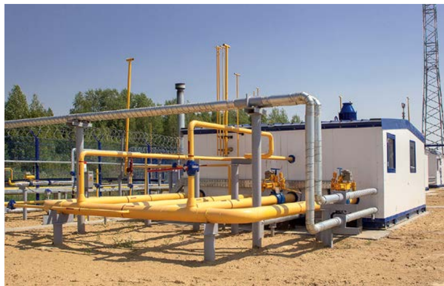
... Автоматическая газораспределительная станция №10 (АГРС-10) Вынгапуровского ЛПУМГ ООО «Газпром трансгаз Сургут» снабжает газом город Ноябрьск Ямало-Ненецкого АО
