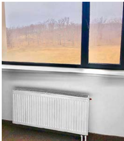
Фото 2. Радиатор Prado Universal в комнате гостиничного номера смонтирован без термостатического элемента
