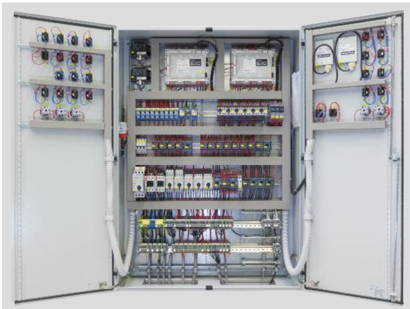
Шкаф управления Weishaupt с двумя менеджерами горения W-FM 200
