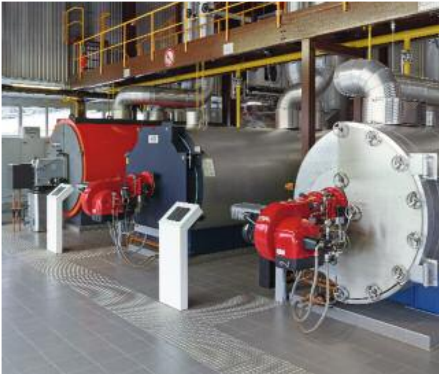
С системой многокотлового регулирования различные типы котлов и горелок работают ещё эффективней
