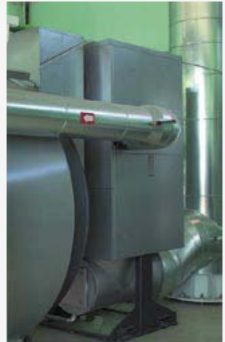
Водогрейный котел серии Vitomax 200, оснащенный экономайзером Vitotrans 333
