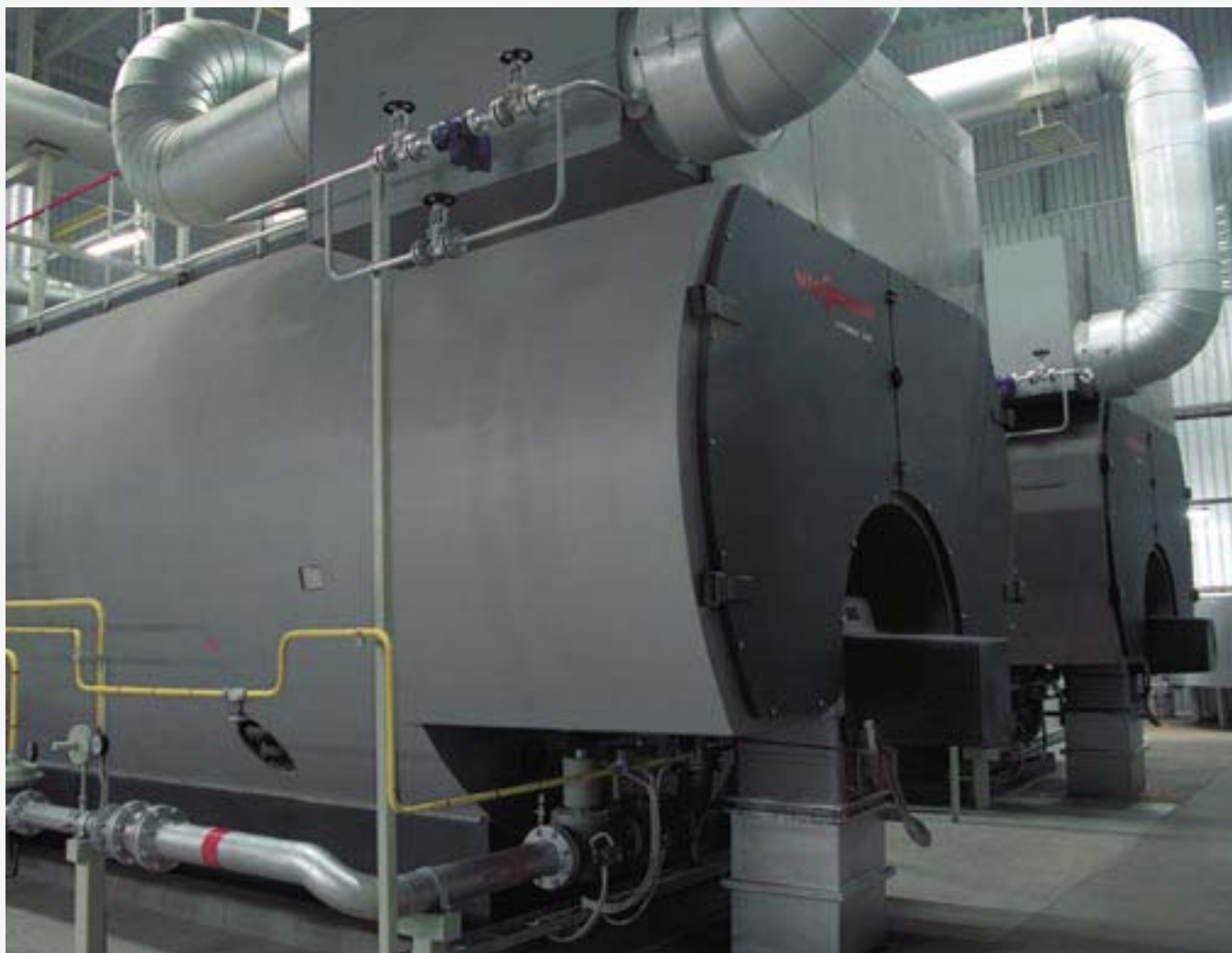
Паровая котельная с двумя котлами Vitomax 200 HS общей производительностью 42000 кг/час. Отбор тепла уходящих газов в экономайзере и регулирование температуры теплоносителя смешиванием сухого насыщенного пара с перегретым паром
