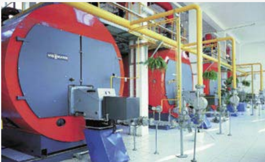
Turbomat-RN-HW – водогрейная котельная 6 x 10 МВт
