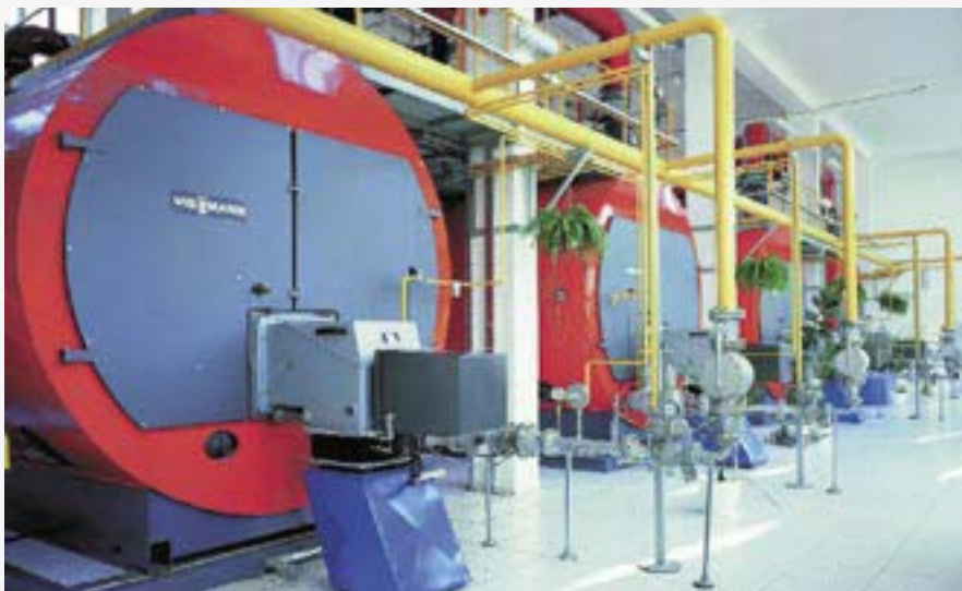
Turbomat-RN-HW – водогрейная котельная 6 x 10 МВт
