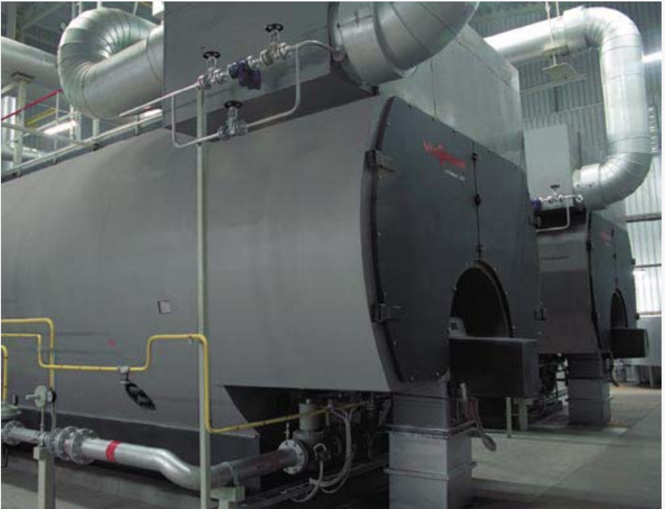
Паровая котельная с двумя котлами Vitomax 200 HS общей производительностью 42000 кг/час. Отбор тепла уходящих газов в экономайзере и регулирование температуры теплоносителя смешиванием сухого насыщенного пара с перегретым паром
