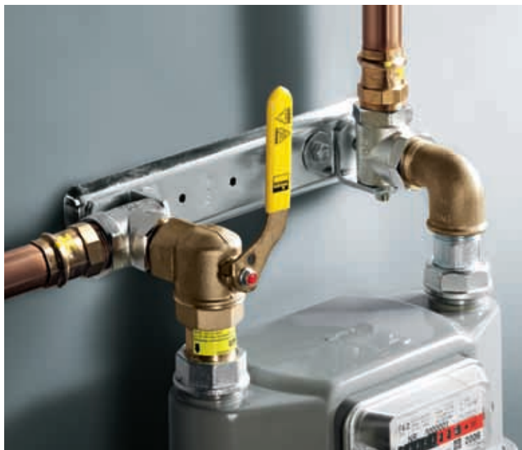
Газовый отсекающий вентиль типа К: на соединении газового счетчика, монтаж вертикально вниз.
