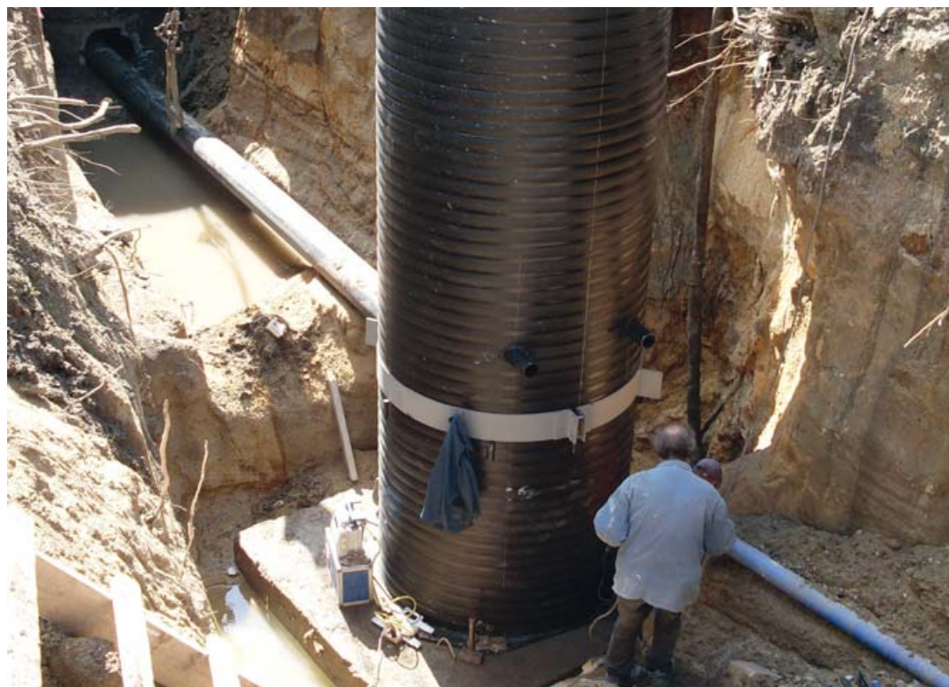
Комплексная канализационная станция в Челябинске.
