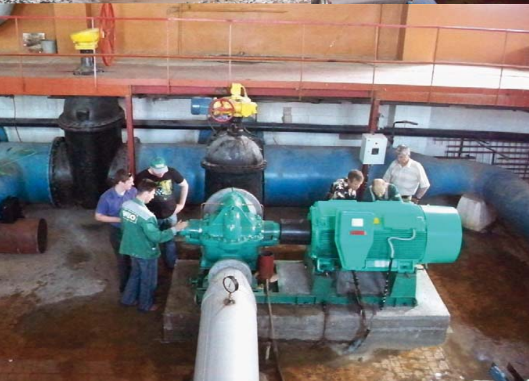
Насосные станции 2-го и 3-го подъема в г. Камышин Волгоградской области.
