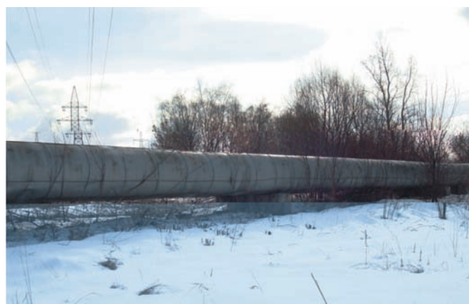
Трубопровод тепловой сети наружной прокладки
