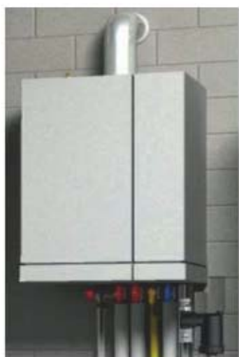
Магнитный сепаратор шлама SafeCleaner, установленный под котлом
