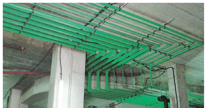
Трубопроводные линии для этажей
