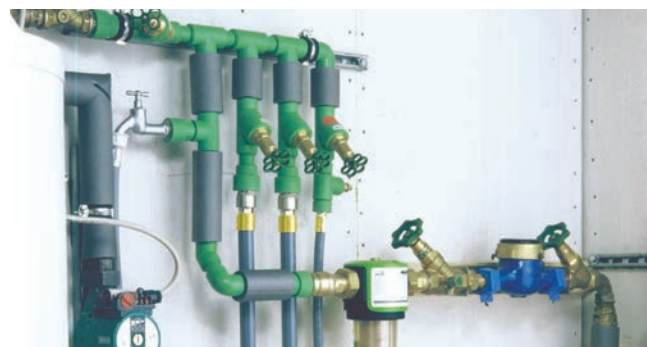
Точка ввода в здание
