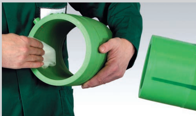
Очистка внутренней поверхности электромуфты неволокнистой салфеткой или тканью. Перед сваркой проверить, нет ли вновь образовавшейся влаги, и удалить её.
