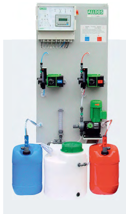
⇨ Установка Oxiperm 164C
