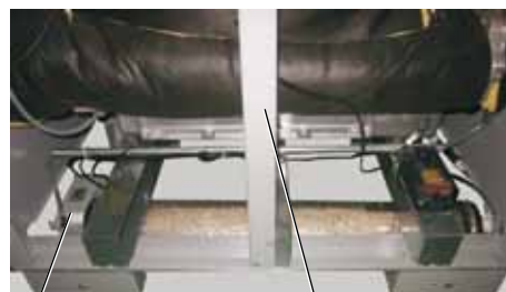
Система подъема конденсата Соединение бустерного насоса и насоса конденсата (соединения выполняются на жгуте проводов за стойкой)
