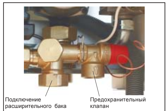
Рис.: Предохранительный клапан, подключение расширительного бака
