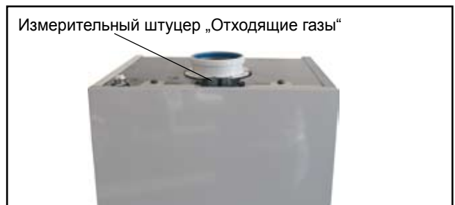
Рис.: Измерение отходящих газов на закрытом котле
