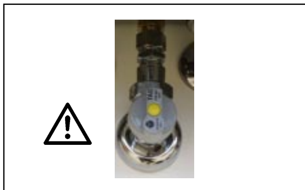
Рис.: Подключение газа: Опасность отравления и взрыва при утечке газа
