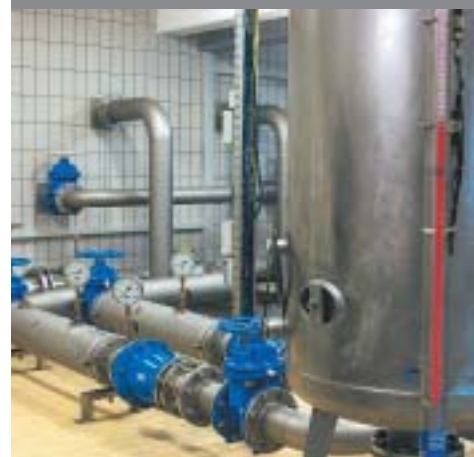
Система водоснабжения в Обертраублинге (Германия)
