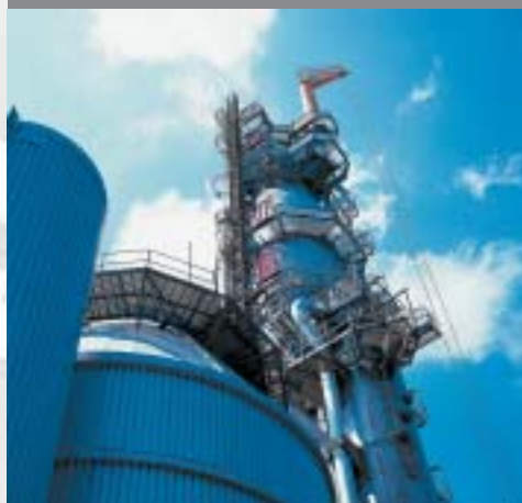
Подача воды на охлаждение в оборотном водоснабжении промышленного предприятия
