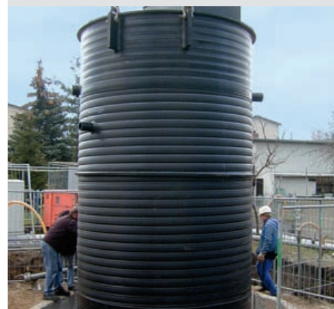
Модернизация насосных станций
