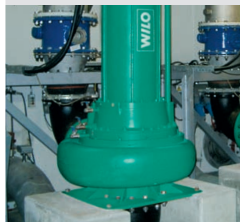
Сухая установка насосов
