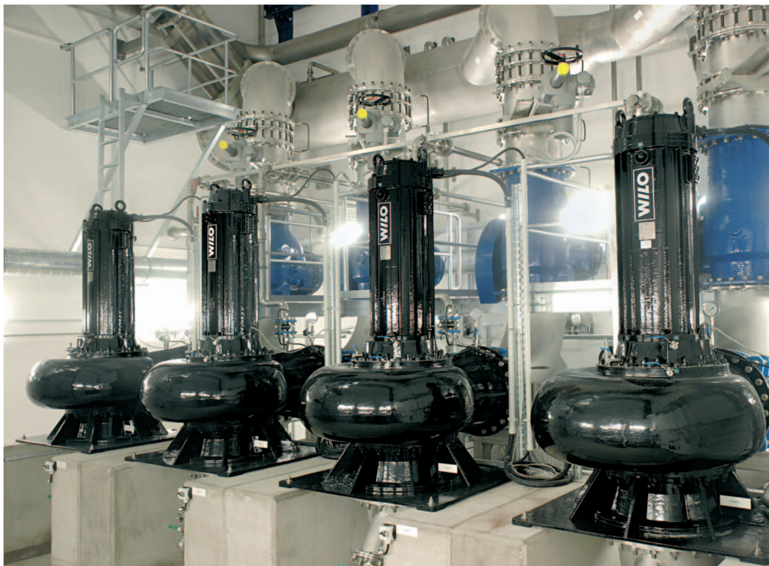
Насосная станция Heidenau, Германия.
