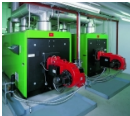
2 горелки RL 30/2-A 3LN, г. Бругг (Швейцария)
