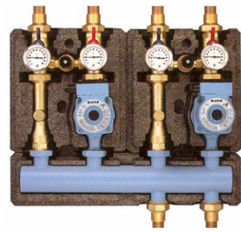
3. Два высокотемпературных контура (радиаторы)
