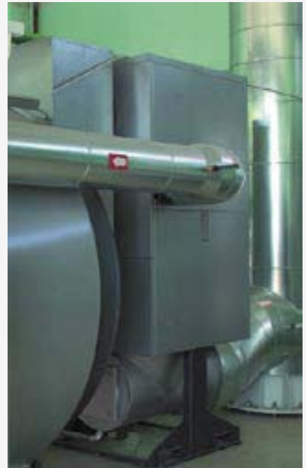
Водогрейный котел серии Vitomax 200, оснащенный экономайзером Vitotrans 333
