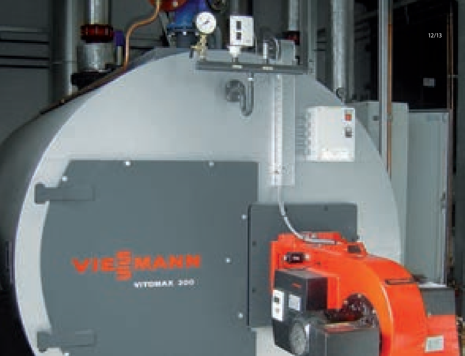
Паровой котел низкого давления Vitomax 200-LS, Тепличные гребницы, Голландия
