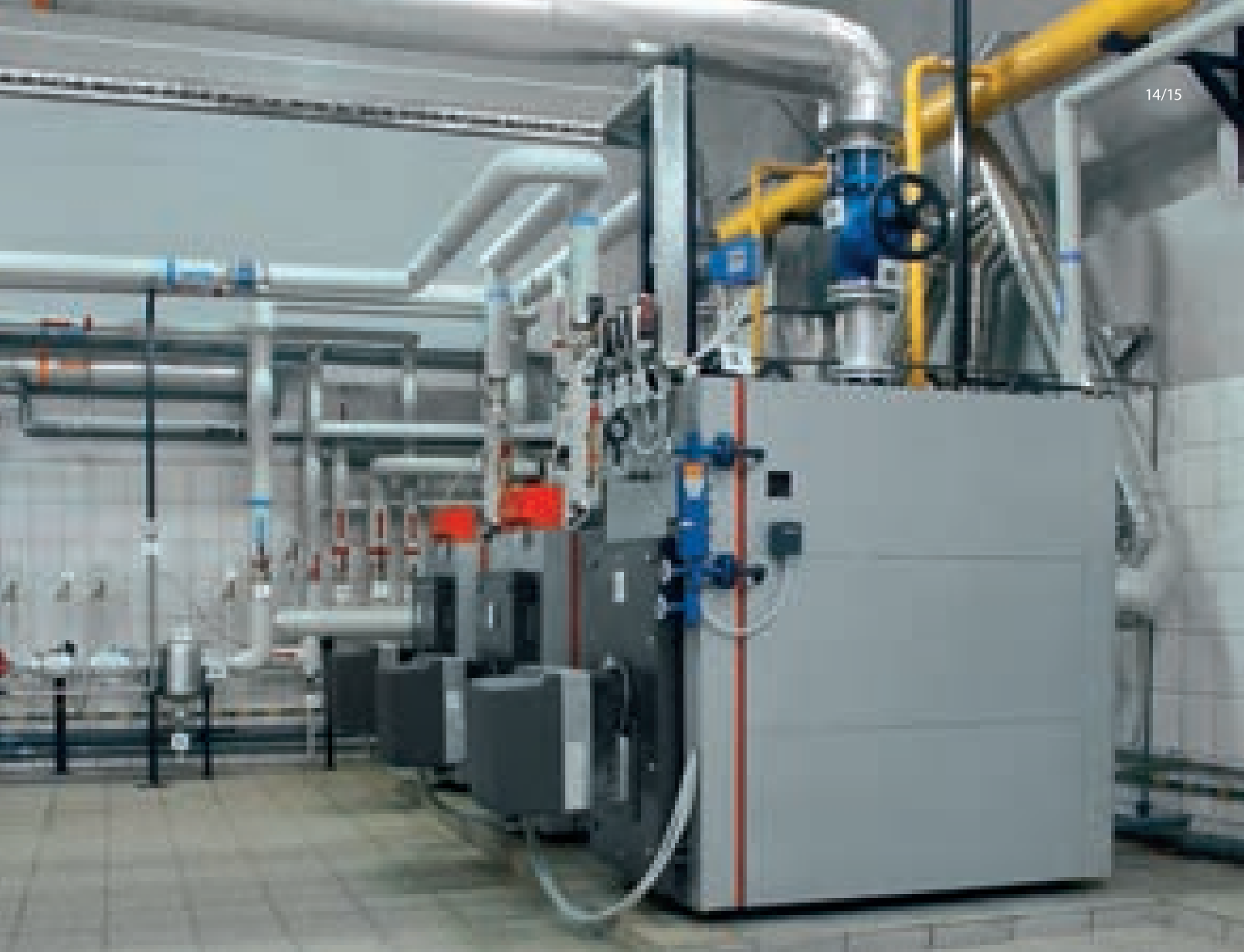
Котельная с паровым котлом Vitoplex 100-LS и двумя водогрейными котлами Vitoplex
