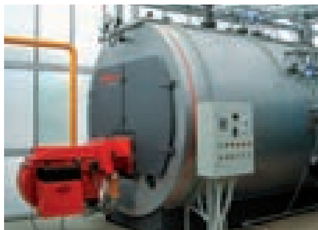
Паровой котел Vitomax 200-HS в фермерском хозяйстве
