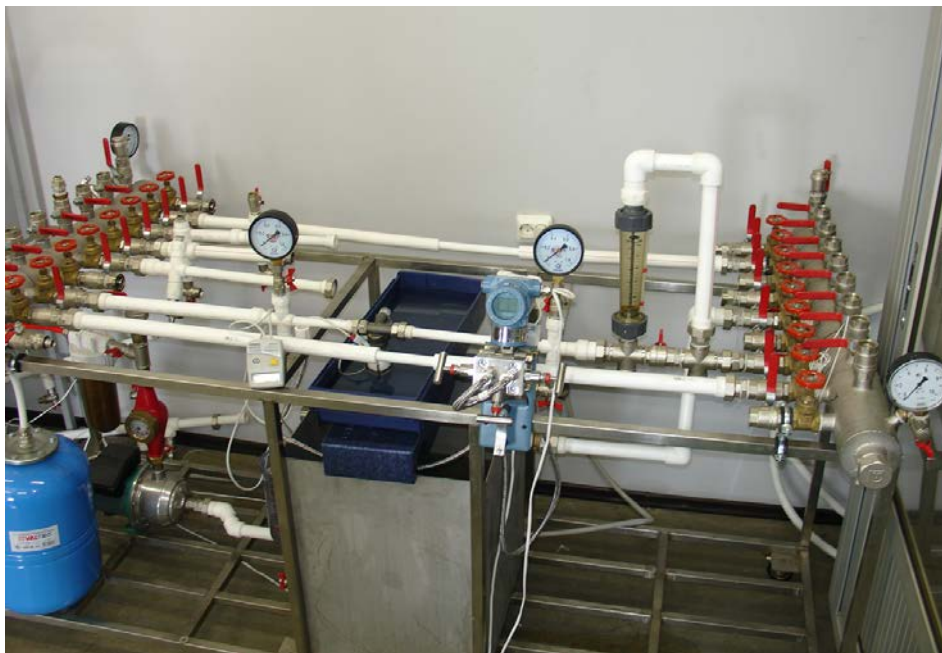
Рис.2.4.3.р.8 Стенд гидравлических испытаний
