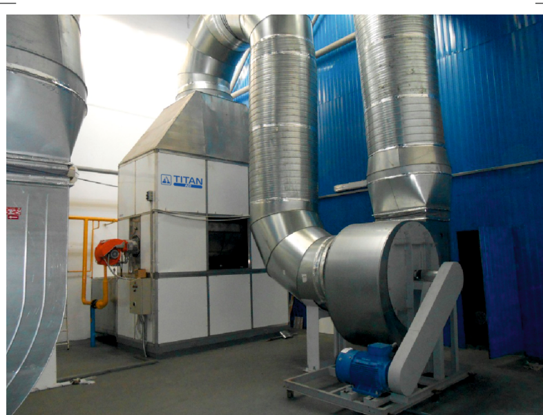
Воздухонагреватели TITAN AIR 920 VSV успешно отапливают завод по выпуску оборудования для добычи, транспортировки и переработки углеводородов в г. Сасово Рязанской области
