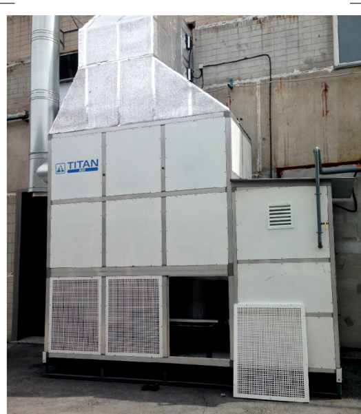
Один из крупных проектов Газтехпром – каскад воздухонагревателей TITAN AIR 800 NSV, отапливающих фабрику по производству мебельной фурнитуры в г. Миасс Челябинской области
