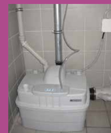
Насосная станция SANICUBIC® 2 Pro смонтирована в подвальном помещении
