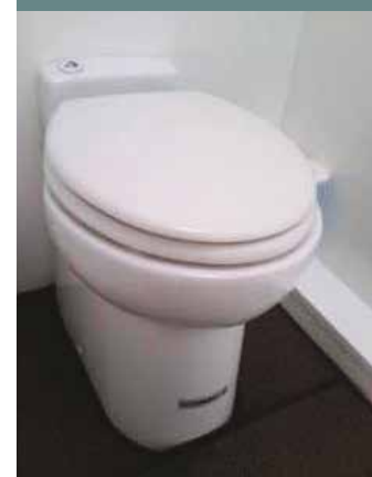
SANICOMPACT® Pro установлен для отвода сточных вод в резервуар
