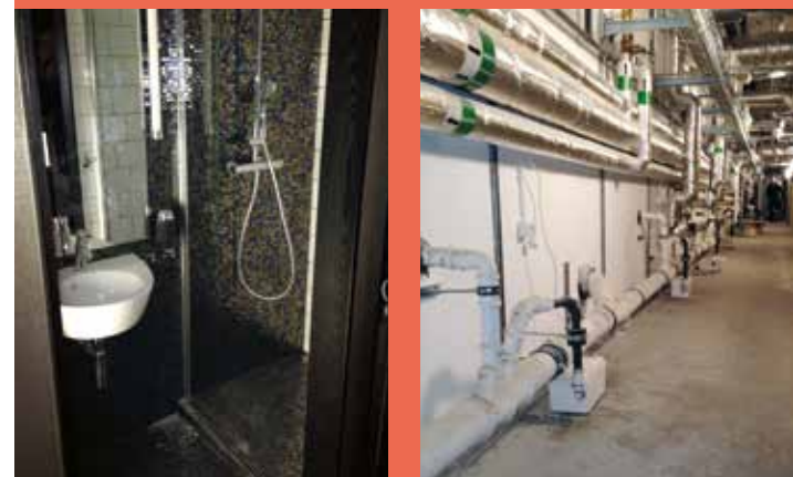
SANIDOUCHE® Flat, установленные в техническом помещении за стеной ванных комнат
