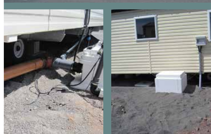
Смонтированная насосная станция SANICUBIC® 2 Pro
