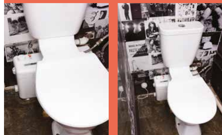
SANIBEST® Pro установлен в туалете в подвальном помещении
