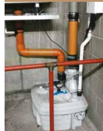
SANICUBIC® 2 XL расположена на техническом этаже
