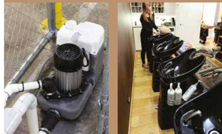
SANICOM® 1 установлена в салоне красоты
