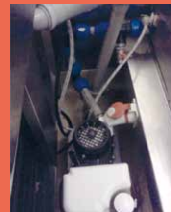
Установленная насосная станция SANICOM® 1
