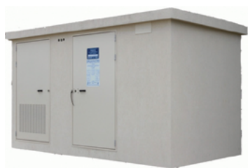
Рис. В44. Пример протестированной комплектной понижающей подстанции с трансформатором, заполненным жидкостью мощностью 1250 кВА
