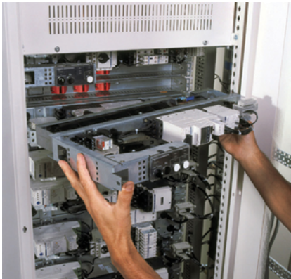
Рис. E31. РУ с вытчными функциональными блоками
