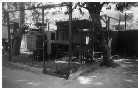
Рис. В54. Подстанция наружной установки без корпуса
