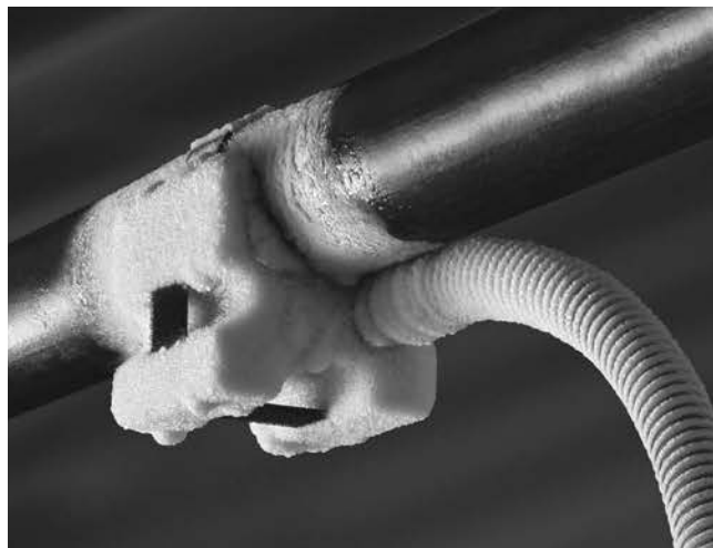
Figur 9 – Frysehoved fastfrosset på rør
