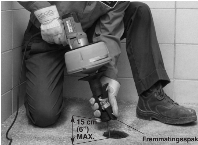
Figur 10 – Mating av kabel med AUTOFEED
