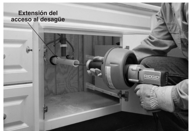
Figura 6 – Manera en que se alarga el desagüe para situar la nariz de la K-45 a menos de 15 cms. (6 pulgs.) del acceso
