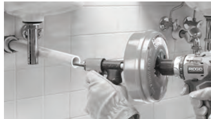
Figura 7 – Forma en que se prolonga la entrada al desagüe para que la nariz del desatascador quede a menos de 4 pulg. (100 mm) del acceso
