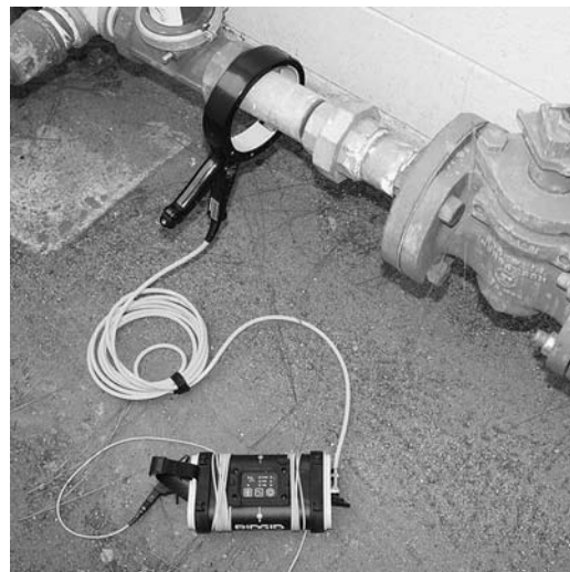
Figure 9: Pince inductive fixée à un conducteur
