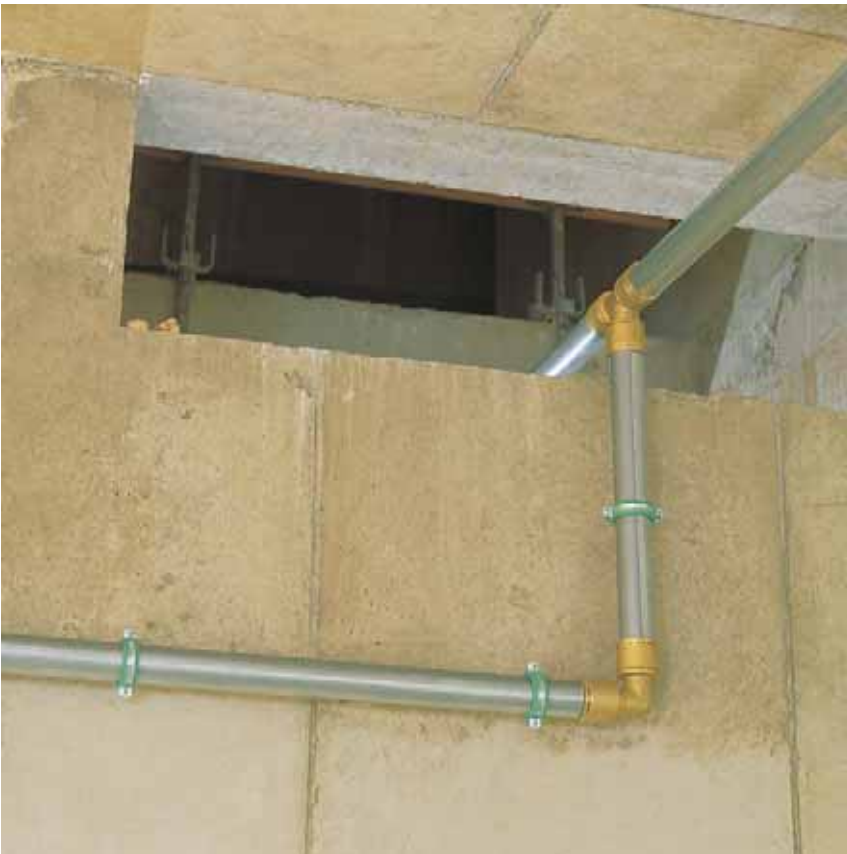
Рис. 121. Магистраль в подвале из труб RAUTITAN flex
