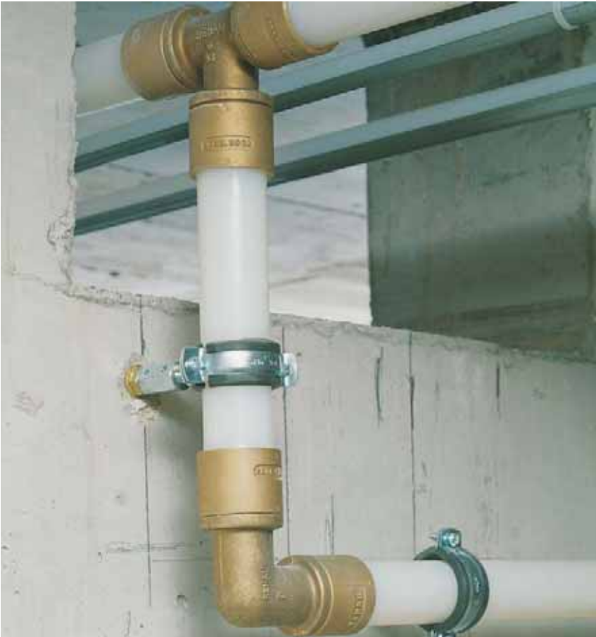
Рис. 123. Магистраль в подвале из труб RAUTITAN his
