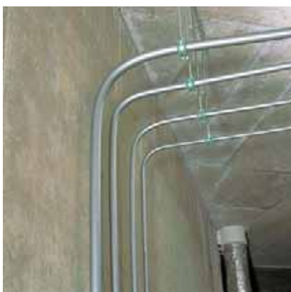
Рис. 116. Стояки, изогнутые под потолком из труб RAUTITAN stabil
