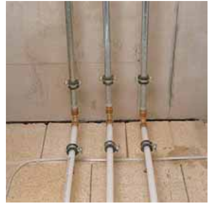
Рис. 125. Магистраль в подвале. Переход из вертикального в горизонтальное положение с помощью труб RAUTITAN his
