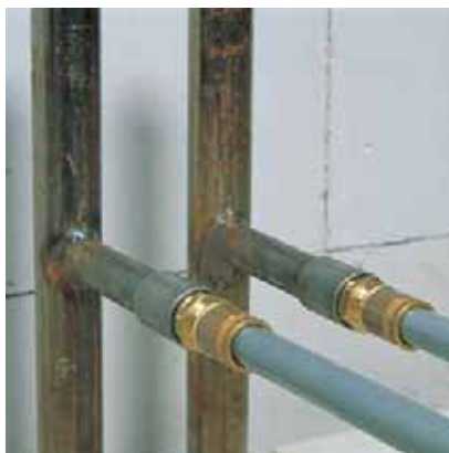
Рис. 73. Переход с труб RAUTITAN на стальные трубопроводы
