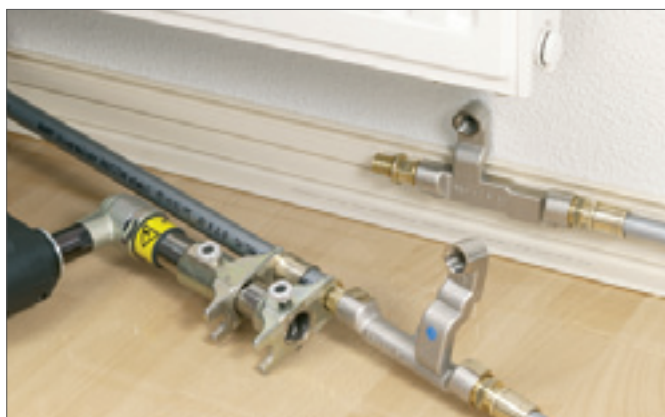
Рис. 18-34 Соединение с помощью подвижной гильзы, трубы \varnothing 16 с крестовиной SL-RAUTITAN из комплекта
