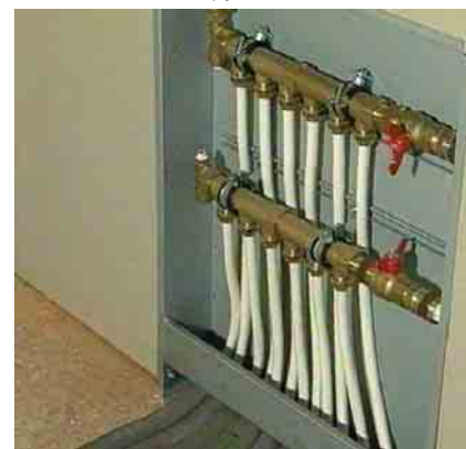
Гребенка в монтажном шкафу для подсоединения радиаторов
