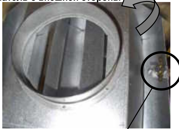
Термостат дымовых газов
