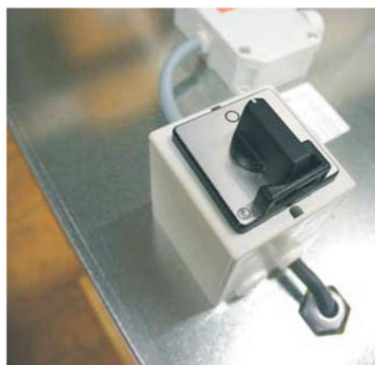
Вентблок Airblock FG с установленным ремонтным выключателем
