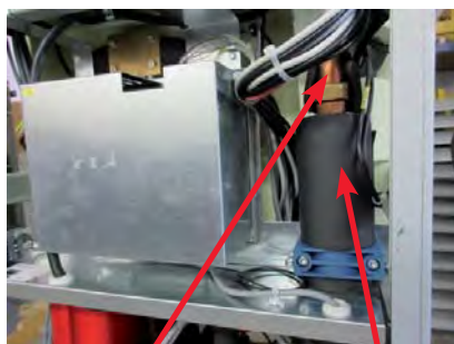
загальна труба подачі електронагрівач
