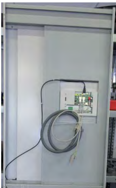
Внутрішня сторона передньої частини з кабелями
