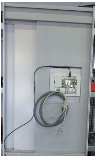
Внутрішня сторона передньої частини з кабелями
