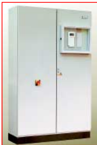
Рис. 19: Модули оператора DigiMaster и DigiEasy, установленные на дверце панели зонального управления
