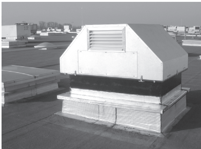
Рис. 1. Установленный на крыше агрегат TopVent® commercial AU
