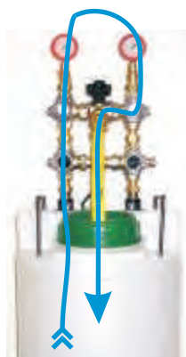
"Altes" Systemwasser über Filtersack führen.
