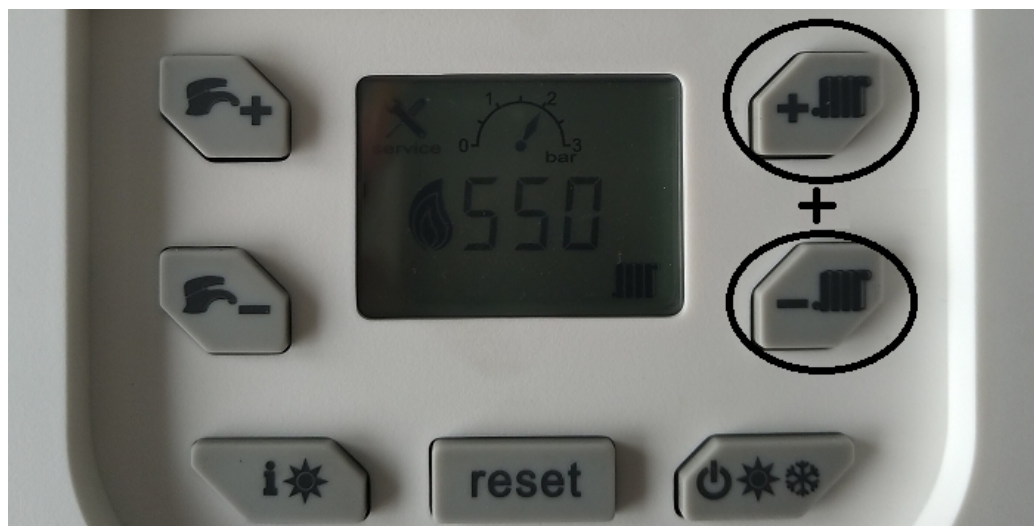
Панель управления котла
