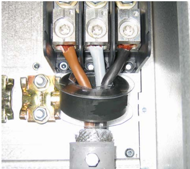
Рис. 49 Ферритовый сердечник установлен на кабелях двигателя
