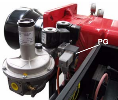
Рис. 29 - Реле давления газа
