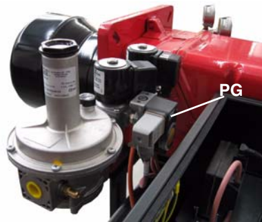
Рис. 22 - Реле давления газа
