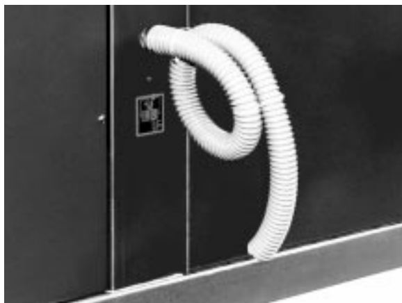
Трубопровод отвода конденсата Наружный Ø 35 мм
