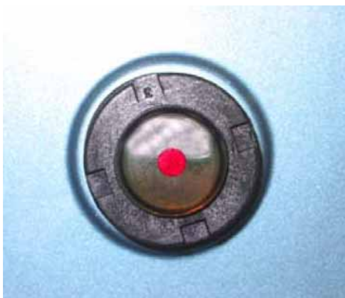
Рис. Фотография индикатора масла, расположенного на конце насоса (в нижней правой части шкафа управления).
