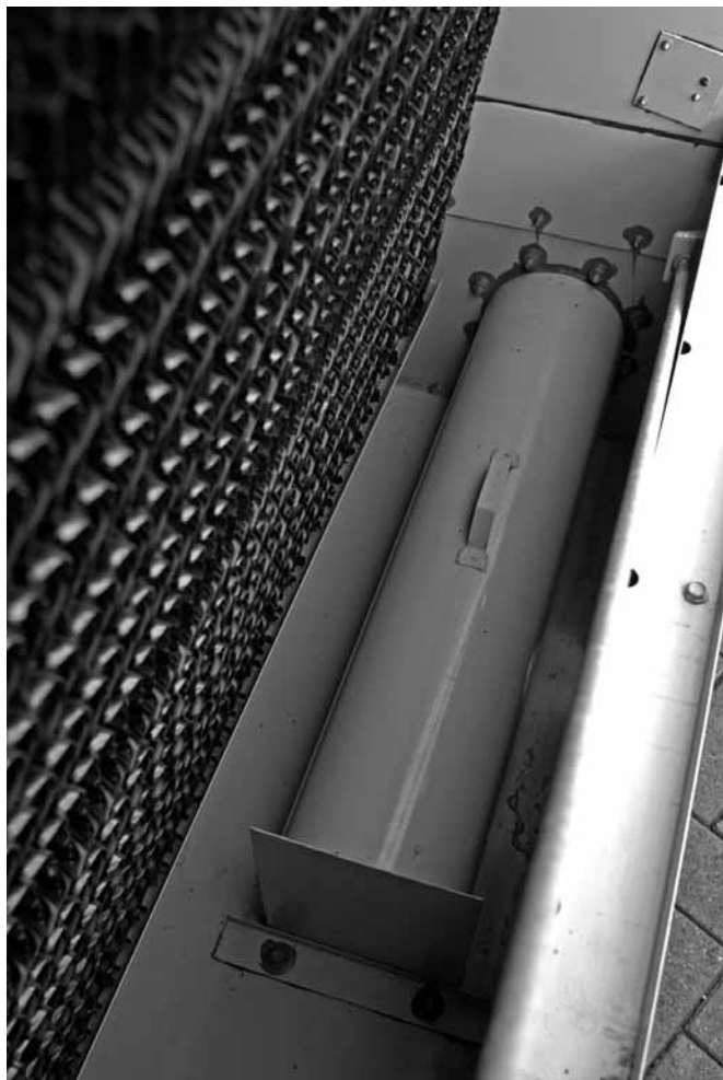
Рисунок 4: Бассейн холодной воды и сетчатый фильтр бассейна
