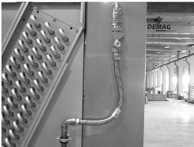
Рисунок 17: Узел подачи воды, подсоединенный гибкой трубкой к городскому водопроводу
