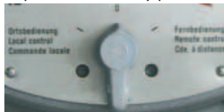
Рис. М-6: Ключ-селектор на панели местного управления
