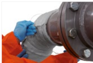
Рисунок 35. Убедитесь, что стыки всех соединений плотно прилегают друг к другу и плотно ложатся на трубу, не образуя ни зазоров, ни пустот.
